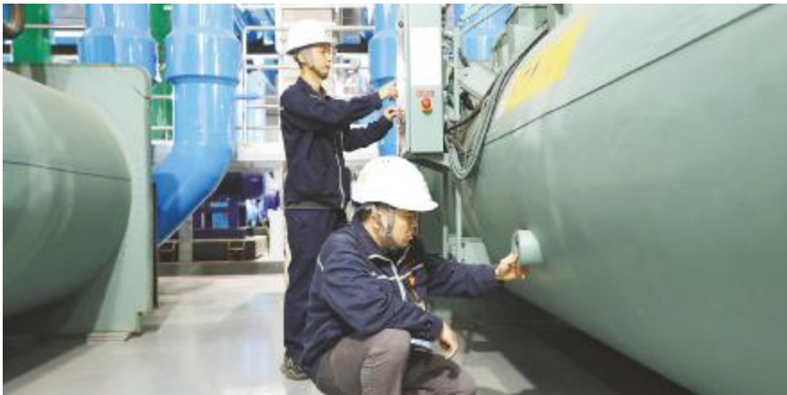
成都公司厂务部动力组动态调整运行参数、挖掘节能潜力
